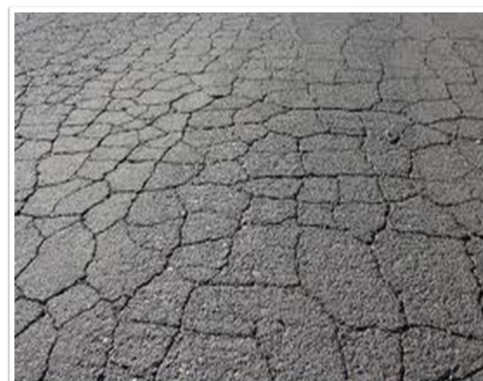
Trincamento por fadiga
