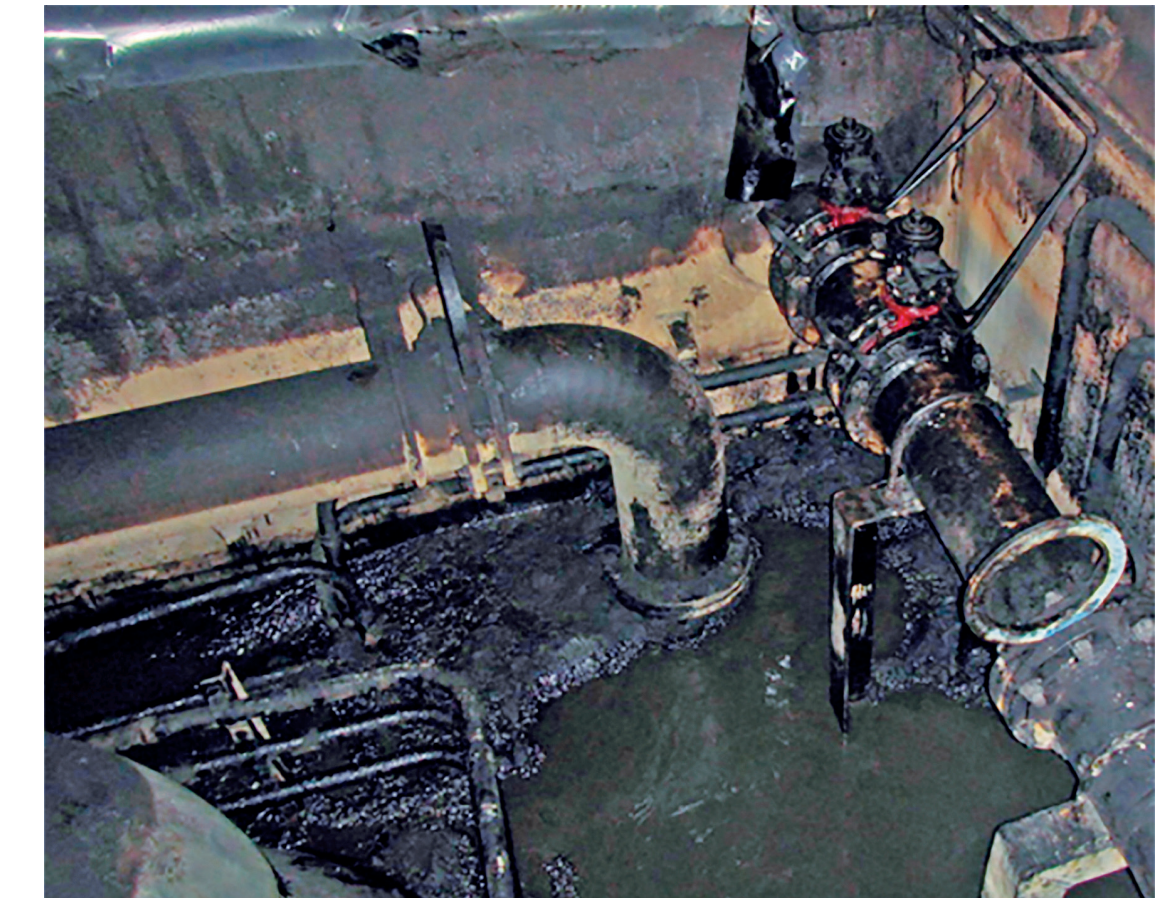
Figura 2: Exemplo de borra oleosa acumulada no fundo de um tanque.
